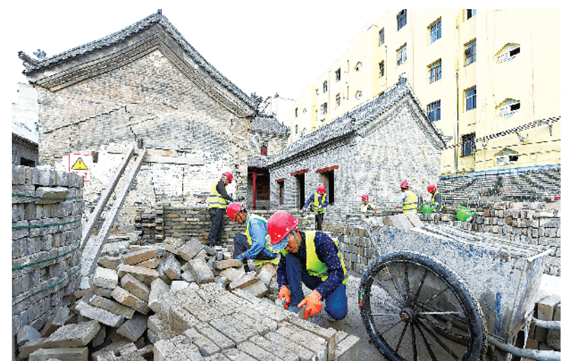
4月12日下午,施工人员在修复周家口抗战指挥部旧址。周家口抗战指挥部旧址位于川汇区周家口南寨历史文化街区,为一处百年以上历史的民居兼商用建筑群,融合了晋派、豫派建筑风格。 记者 梁照曾 摄
